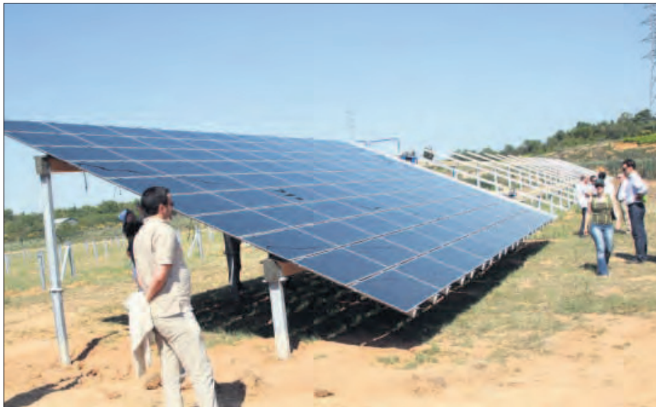
Ce type de centrale solaire comme celle en cours de construction près de Narbonne devrait se développer dans les P.-O. Ph. Archives.
