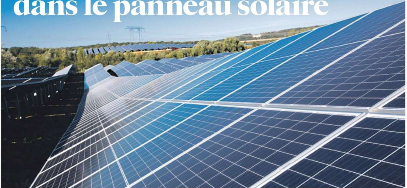
La ferme d'Engie Green, installée sur une ancienne friche à Marcoussis (Essonne), est la plus grande centrale solaire au nord de la Loire. ROMUALD MEIGNEUX/SIPA
